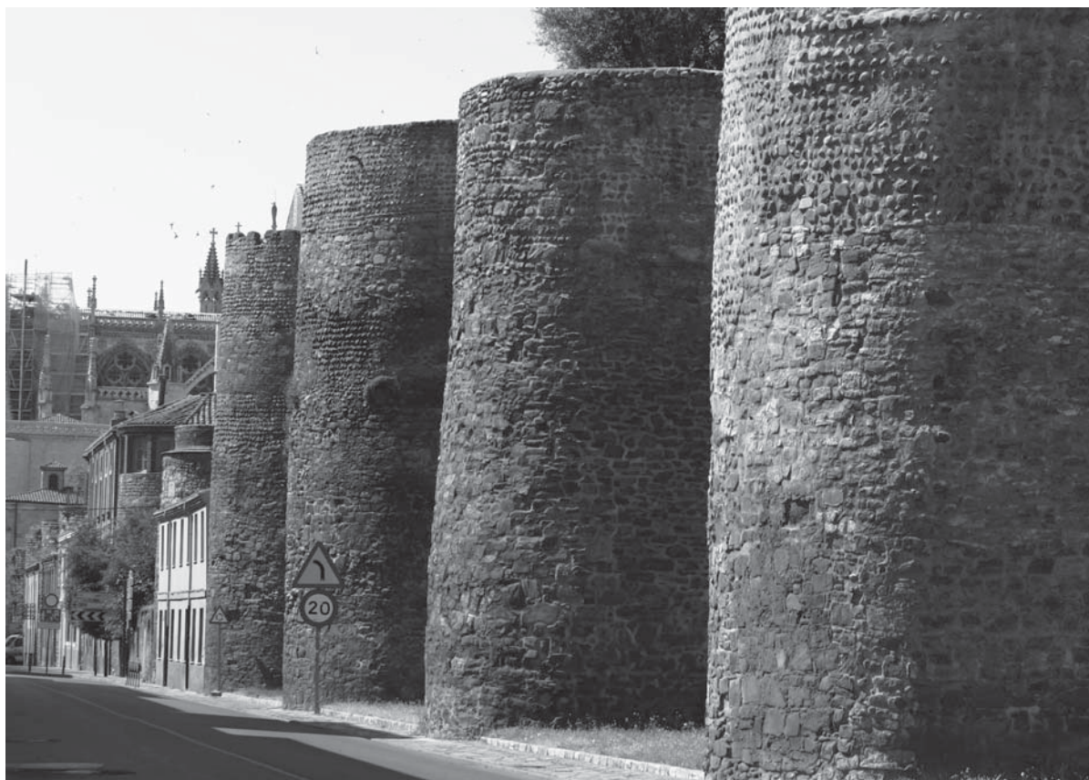
Fig. 2. León. Lienzo oriental de la muralla de cubos tardorromana con reparaciones posteriores superpuestas.
