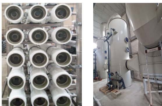
Figura 35. Filtración con membranas, y equipo de desodorización
