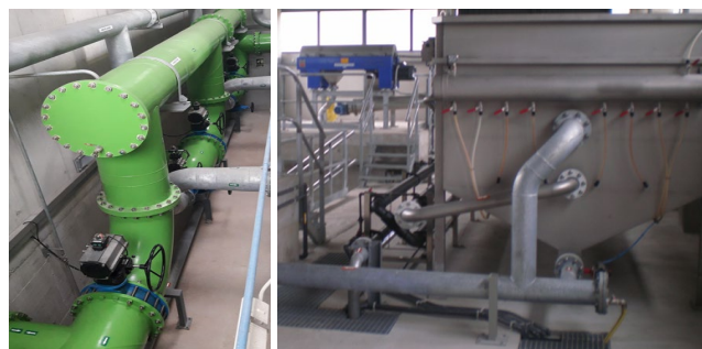
Figura 14. Bombas y manejo de lodos
