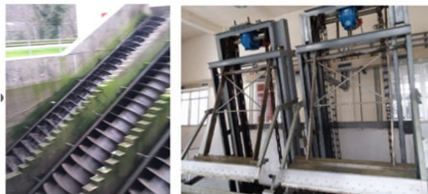
Figura 15.: Tornillo de Arquímedes y reja de gruesos
