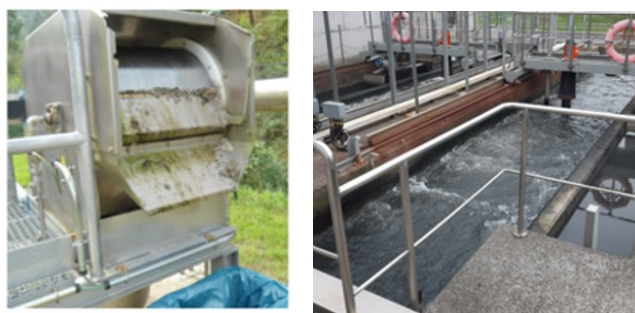
Figura 16.: Cribado y desarenado
