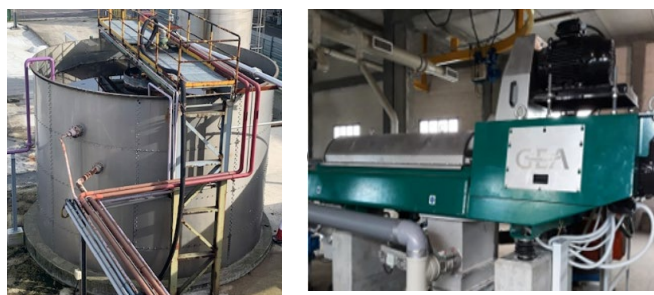
Figura 38. Tanque de espesamiento, y centrífuga horizontal
