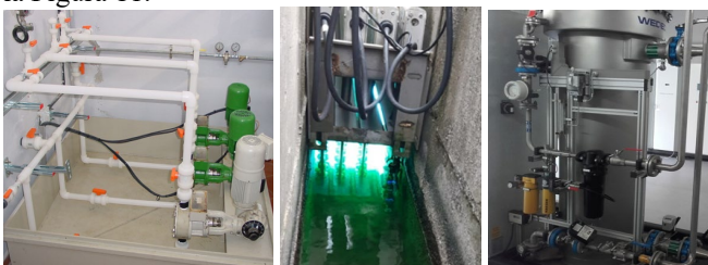
Figura 11. Cloración. Luz Ultravioleta. Ozonización
