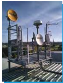
Balcón de antenas de comunicaciones y estación de seguimiento de satélites.
