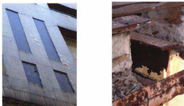
Figura 1. Deterioro de la fachada y de la estructura del edificio Rey Pelayo previo a su rehabilitación energética. (Esfer, 2010)
