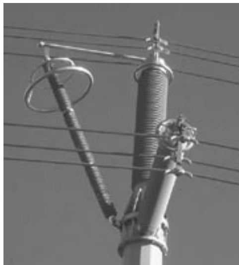
Torre compacta de 400 kV sin cable apantallado aéreo. Aisladores protegidos por TLA en fase superior.
